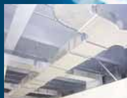
Przewody wentylacyjne Canalizzazioni
